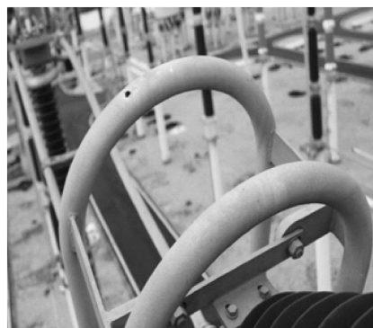
图 5 断路器母线侧断口的均压环
